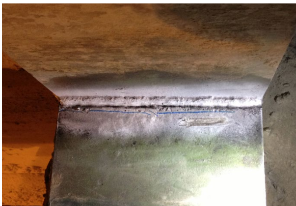
Bild 9. Ermüdungsriß am Obergurt einer Auflagerkonsole
