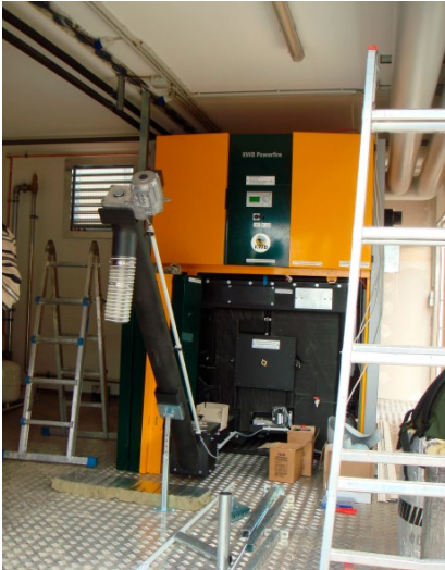
Der Heizenergie- und Warmwasserbedarf wird durch einen umweltfreundlichen Pelletskessel und einen Solar-Wasserspeicher gedeckt.
