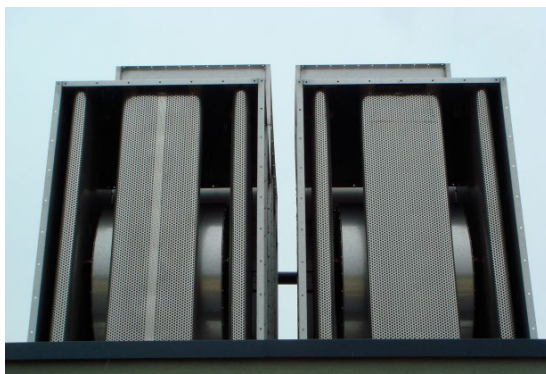
Der Kühlenergiebedarf wird über ein modifiziertes Nachtkühlsystem mit Befeuchter bereitgestellt, wobei der ohnehin erforderliche Sprinklertank als Kältespeicher dient
