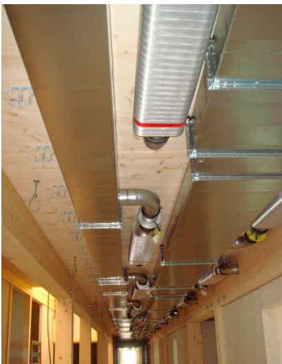
Auch die Be- und Entlüftung und das dazugehörige Leitungsnetz wurden energetisch optimiert
